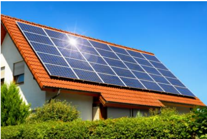
Aufgesetzte Photovoltaikanlage mit optimalem Randabstand zum First, der Traufe und dem Ortgang. Hat jedoch ungünstig starke Rasterung.
